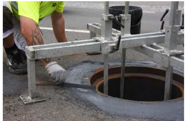
Ved sætninger i asfalten omkring brønden opfyldes disse
